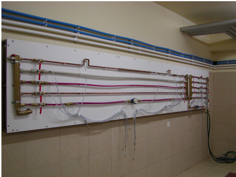
Rys.. 3.3. Widok ogólny stanowiska pomiarowego
