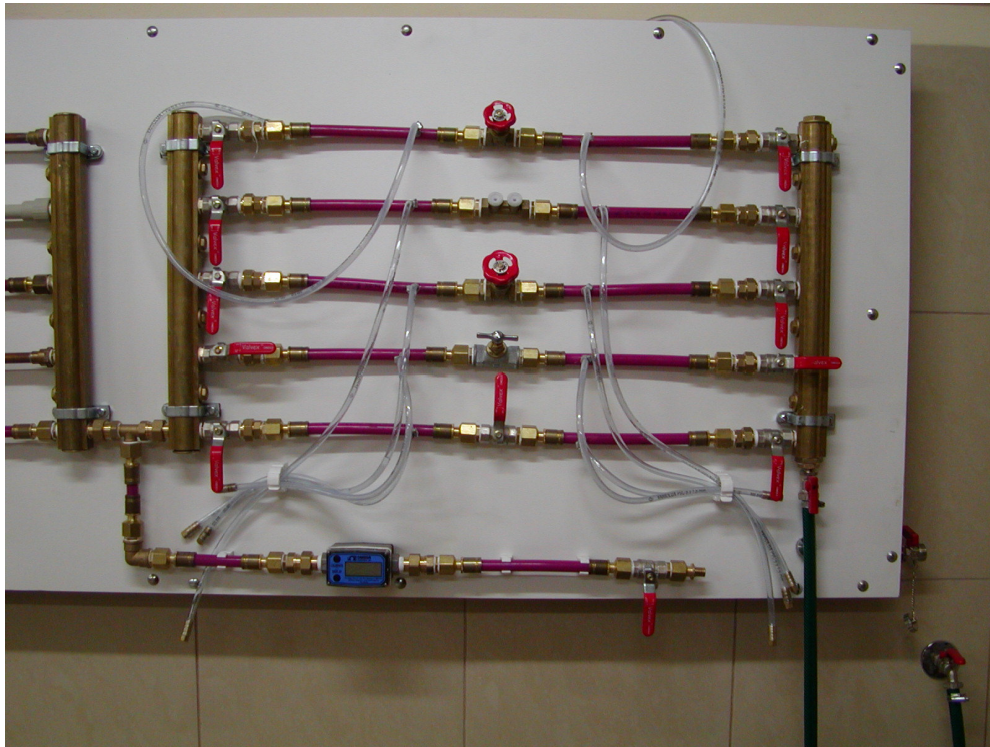
Fot. 4.2. Widok stanowiska badawczego
